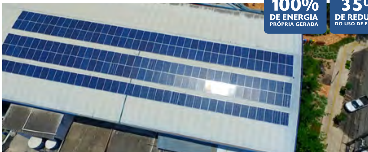
Painéis solares no edifício sede do Sebrae/CE
